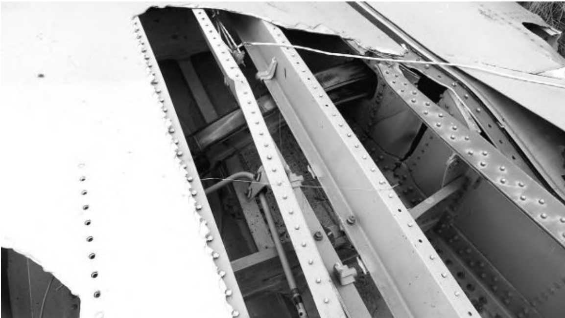
Рис. 34. Повреждения несущей плоскости
